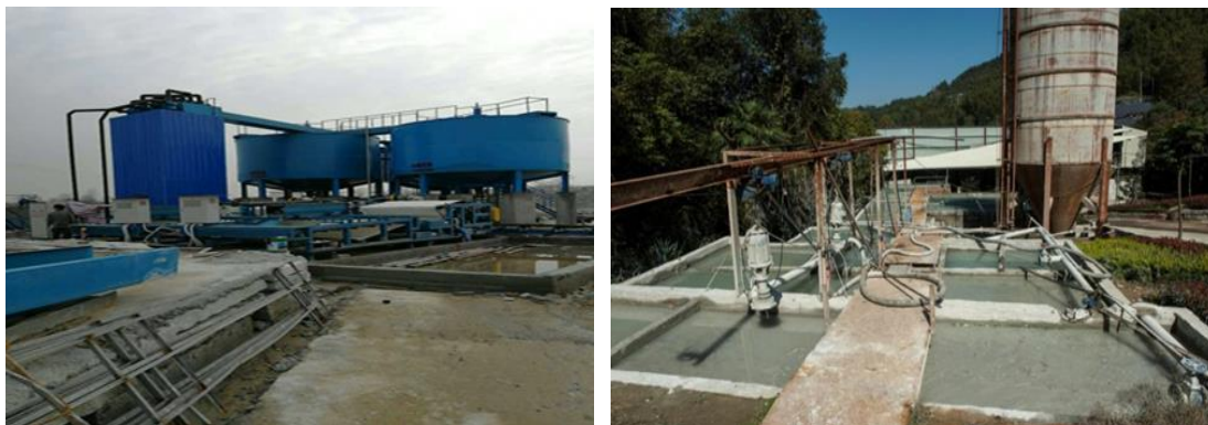
图 6-2 矿山污水处理设施
